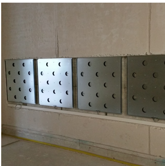
Sensorflächen auf Betonwand montiert
